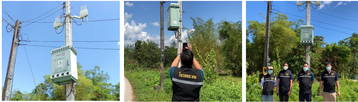
รูปทดสอบการใช้งานจริงบริเวณจุดติดตั้ง Wi-Fi หมู่บ้าน หมู่ 1 บ้านตากแดด ต.ท่าอยู่ อ.ตะกั่วทุ่ง จ.พังงา
