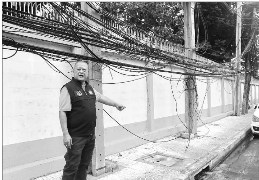
เร่งแก้ไข : วิศวกร พันธุ์หาญ ผอ.เขตบางกะปิ พร้อมเจ้าหน้าที่ฝ่ายที่เกี่ยวข้อง ลงพื้นที่บริเวณซอยเสรีไทย 7 ตรวจสอบเรื่องร่องรอยการฉีกสายสื่อสารห้อยย้อยรุงรังเป็นอันตราย และกีดขวางทางสัญจร ซึ่งได้มอบหมายเจ้าหน้าที่ฝ่ายโยธาประสาน กสทช. เร่งแก้ไขแล้ว
