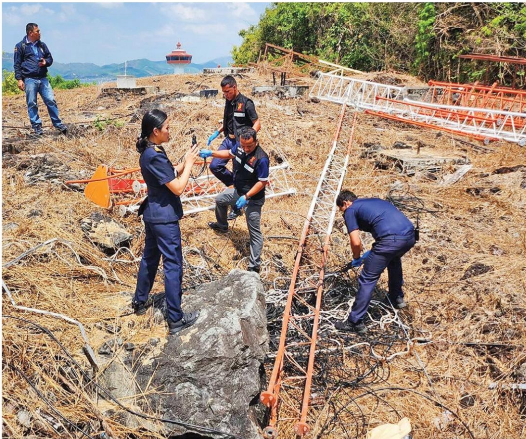
📍 เสาสัญญาณ - พล.ต.ท.วรวัฒน์ วัฒนันครบัญชา ผบช.สอท. สนธิกำลังร่วมกับ กสทช. และดีเอสไอ รื้อถอนเสาสัญญาณโทรศัพท์มือถือเถื่อน ที่แก๊งคอลเซ็นเตอร์ลักลอบติดตั้งไว้หลายจุด บริเวณริมชายแดนด้าน จ.ระนอง เมื่อวันที่ 2 มี.ค.
