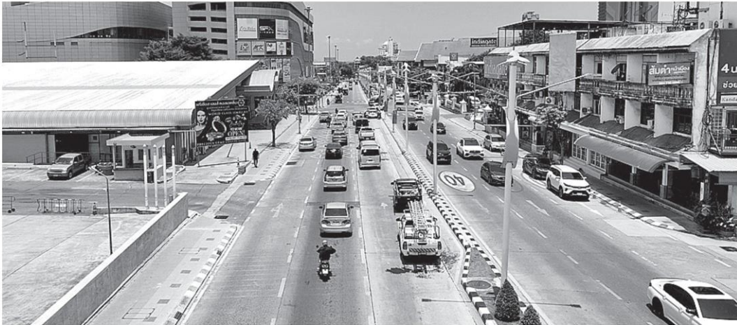
เมืองพัทยา จ.ชลบุรี เดินหน้าโครงการนำสายไฟฟ้าลงดิน ภายใต้งบประมาณ 3,100 ล้านบาท เป็นหนึ่งในโครงการขับเคลื่อนตามนโยบายปรับปรุงภูมิทัศน์และยกระดับคุณภาพชีวิตคนพัทยา สร้างความมั่นคงระบบไฟฟ้าและระบบโทรคมนาคม.
