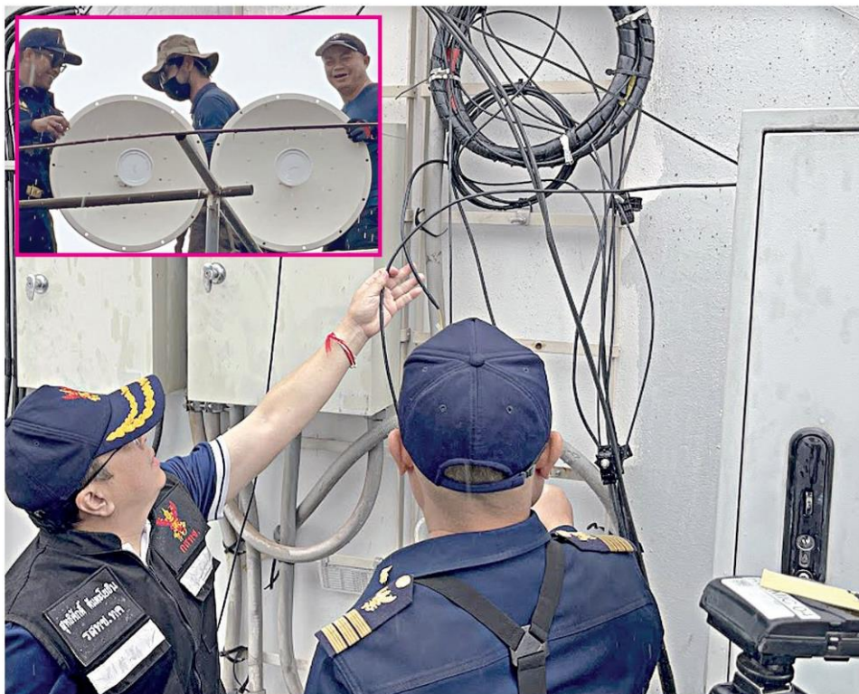
▲ ตรวจเข้ม... คณะกรรมการ กสทช. ร่วมกันตรวจสอบสถานีวิทยุคมนาคมและการให้บริการโทรคมนาคม บริเวณชายแดนในพื้นที่ อ.เมืองหนองคาย 3 จุด พบหันทิศทางไปทาง สปป.ลาว (ภาพเล็ก)
