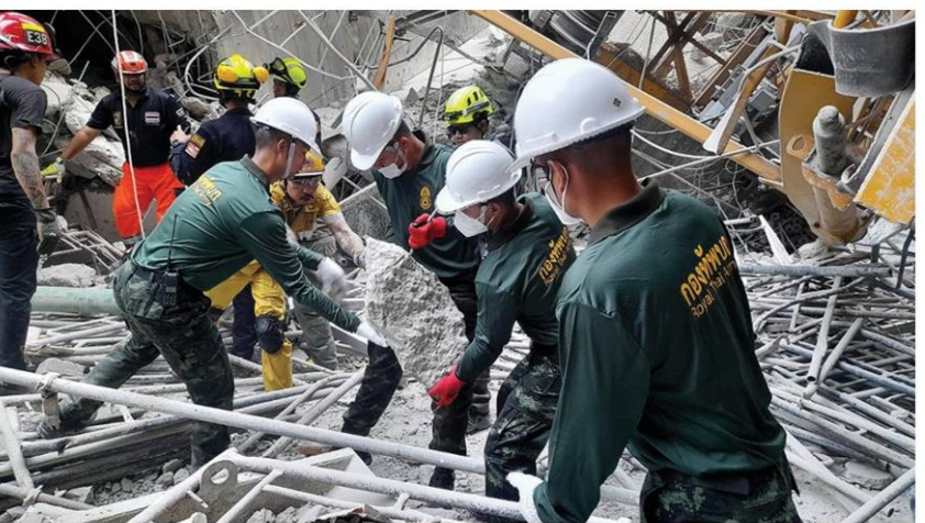
เร่งช่วยเหลือ - เจ้าหน้าที่กู้ภัยร่วมกับกองทัพบก เร่งปฏิบัติการเข้าช่วยเหลือผู้ประสบภัยแผ่นดินไหว จากอาคารที่ทำการสำนักงานการตรวจเงินแผ่นดินแห่งใหม่ที่กำลังอยู่ระหว่างการก่อสร้างในเขตจตุจักร กรุงเทพฯ พังถล่มและมีผู้ติดค้างในอาคารจำนวนมาก เมื่อวันที่ 28 มีนาคม
