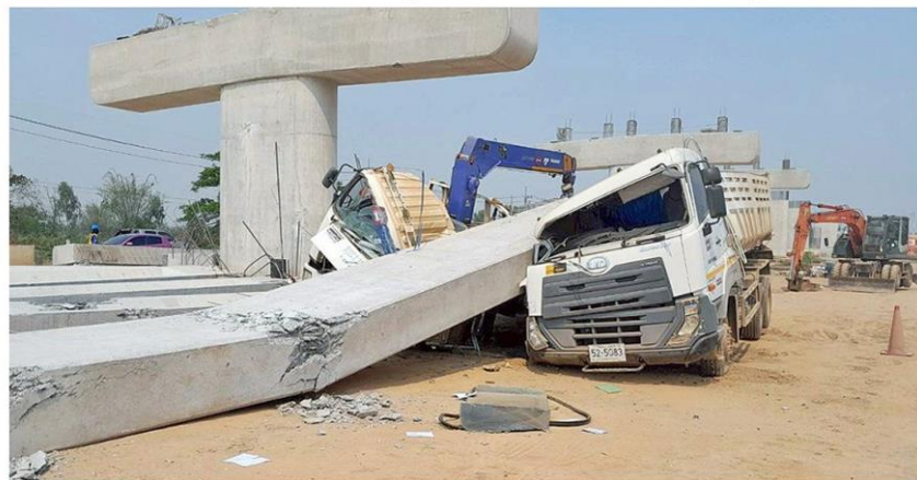
คานคอนกรีตหลายท่อนที่อยู่ระหว่างการก่อสร้างโครงการรถไฟฟ้าสายเด่นชัย-เชียงใหม่-เชียงใหม่ของ ตกลงมาทับรถยนต์ได้รับความเสียหายหลายคัน บริเวณหมู่บ้านโป่งศรีนคร ต.โรงช้าง อ.ป่าแดด จ.เชียงใหม่
