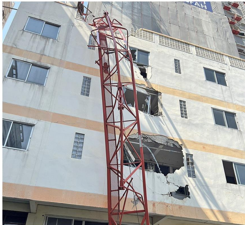
เครนหักพังระหว่างก่อสร้างคอนโดแห่งหนึ่งย่านบางโพ กทม. สูงกว่า 20 ชั้น เป็นเหตุให้คนขับเครนตกลงมาเสียชีวิต
