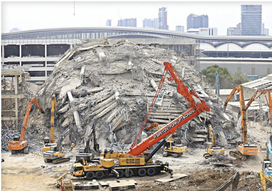
▲ ลุยรี... จนท.ปรับแผนใหม่ใช้เครื่องจักรกลหนักหรือถอนซากอาคารสำนักงานการตรวจเงินแผ่นดิน (สตง.) วันแรก หลังแผ่นดินไหวถล่มมีผู้เสียชีวิต-บาดเจ็บ-สูญหายจำนวนมาก โดยหวังว่าจะมีผู้รอดชีวิต
