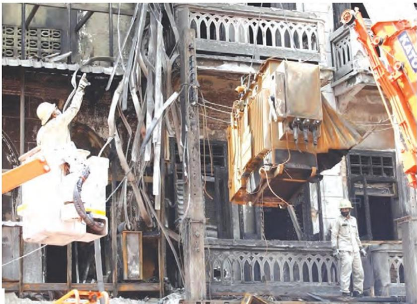
ในพื้นที่อื่นๆ พบการหม้อแปลงที่มีสายสื่อสารรุงรังไม่ต่างกัน ซึ่ง กฟน. สำรวจพบจุดเสี่ยงพื้นที่ใน รุงเทพฯ ชั้นใน หม้อแปลง 400 กว่าลูก
